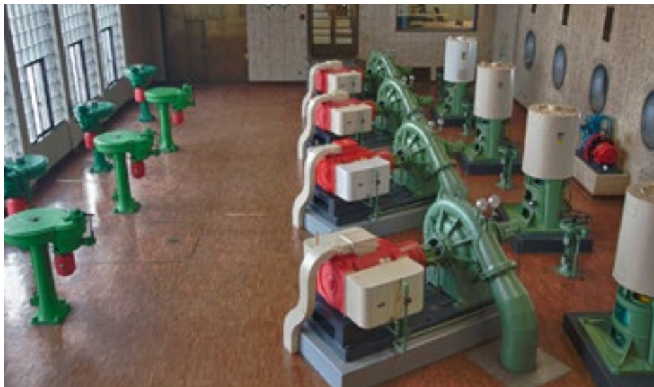
Am Pumpwerk Schönau in Bern wird die zeitliche Verschiebung von Stromlasten praxisnah getestet.
